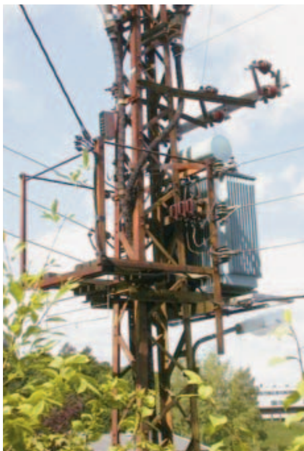
Rustent mastearrangement. Foto: DSB
