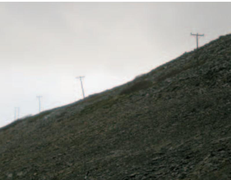
Skjeve stolper på vindutsatt område. Foto: Norconsult
