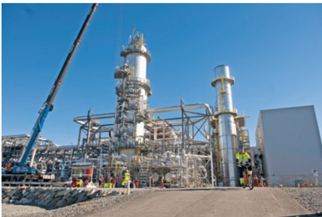
Kraftvarmeverket på Mongstad.
