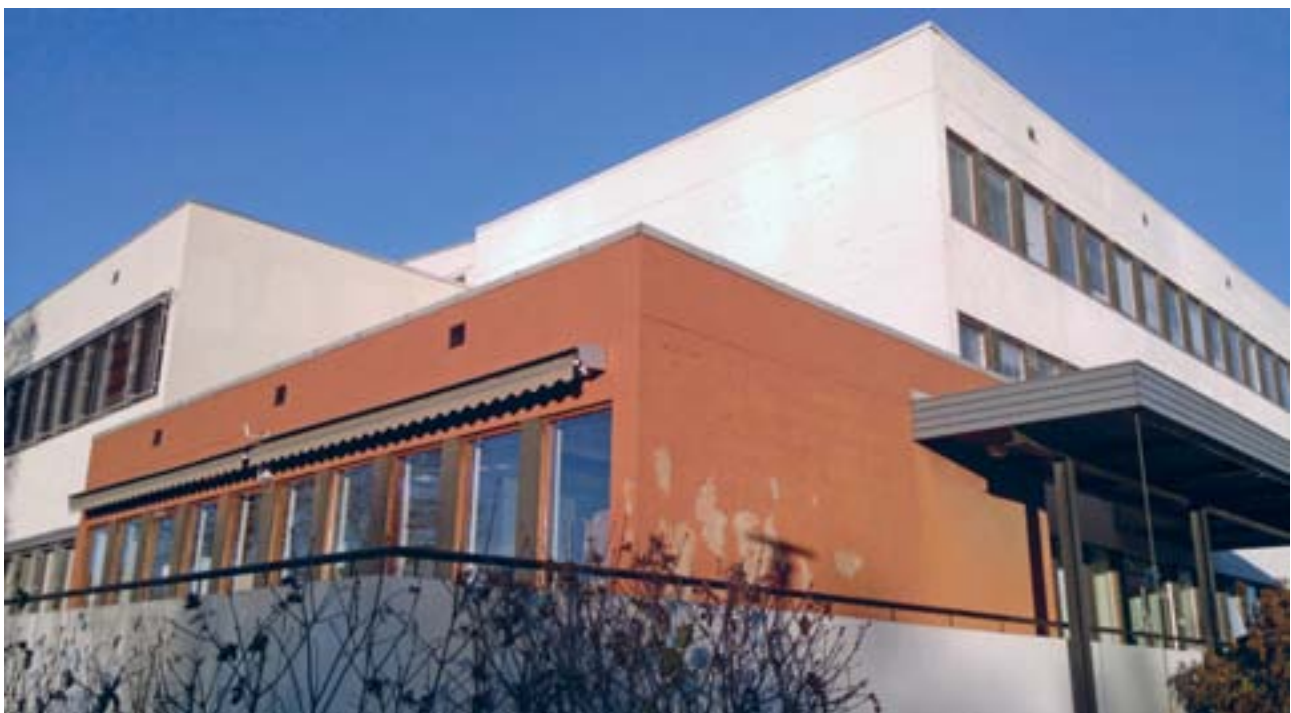
Eksempel på bygg i dårlig tilstand.
